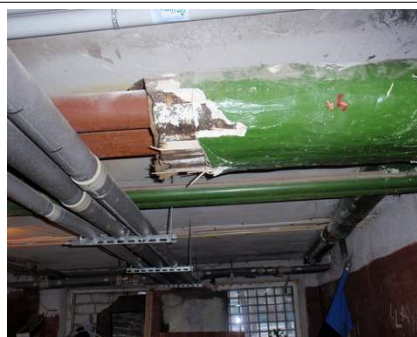
Torustikud ja isolatsioon
