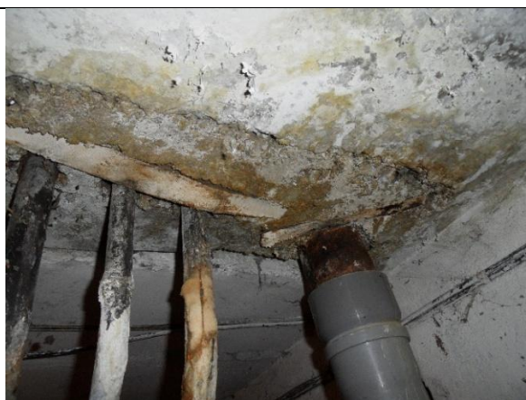
4.Kanaliseatsioonitoru juures tuleb niiskus läbi
