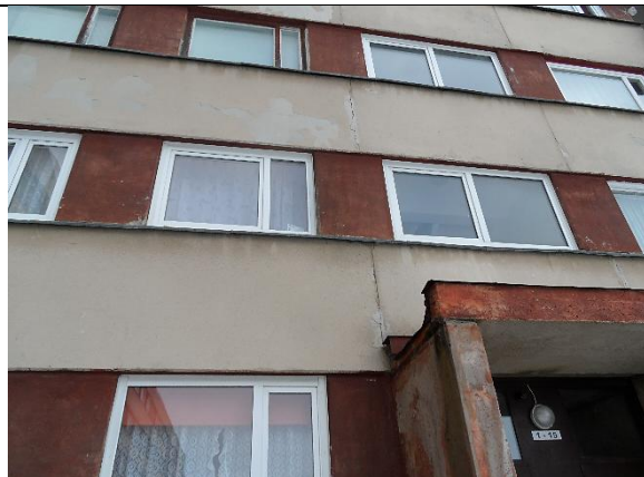
8. Paneelide pragunenud vuugid on külmasillaks
