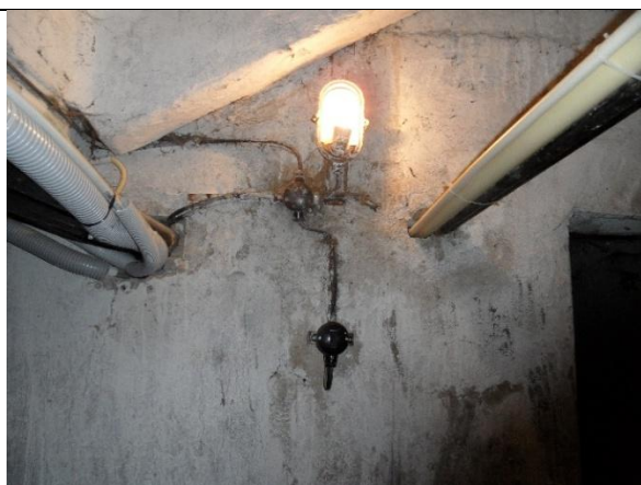
3.Vanad valgustid ja elektrikaablid keldris
