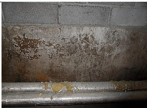
5.Kasside lõhutud torude isolatsioon
