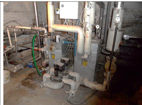
5.Soojussõlm kahe plaatsoojusvahetiga
