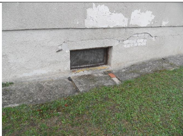
8. Pandus on äravajunud ja vesi jookseb vundamendi vahele
