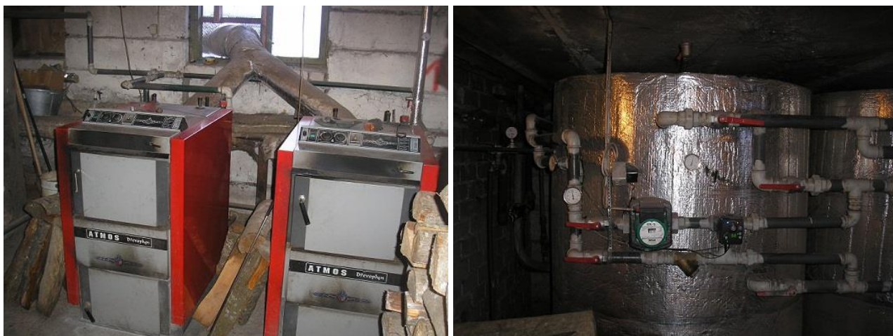
Foto 4. Hoone katlaruumi seadmed
