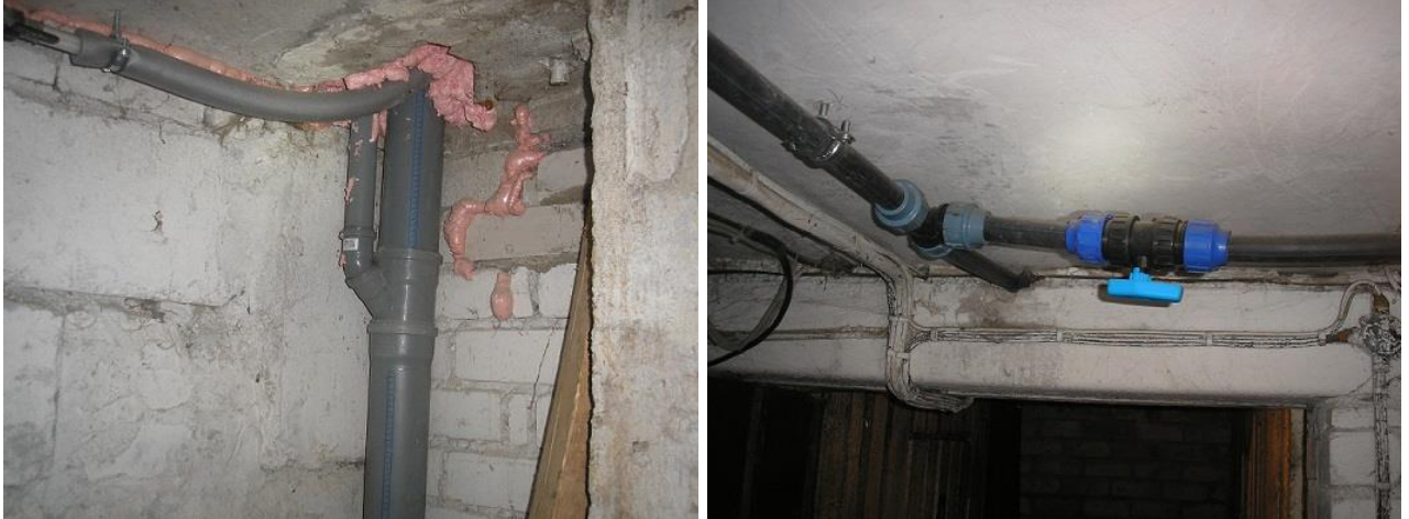
Foto 6. Hoone kanalisatsiooni ja tarbevee torustik
