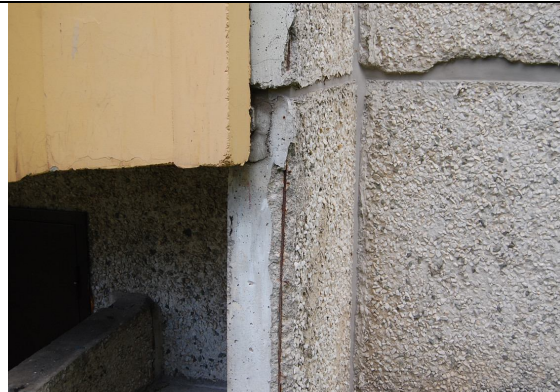
Foto nr. 5. Mõnedel paneelidel on kahjustused. Armatuur on korrodeerunud.
