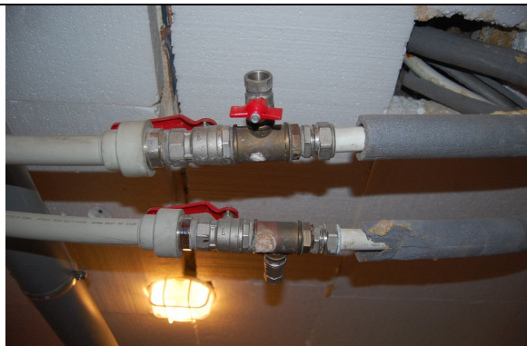
Foto nr. 23. Vee- ja kanalisatsioonitorude püstikud. Konstruktsioonidest kommunikatsioonide läbiviigid ei vasta tuleohutuse normidele.
