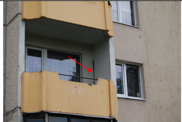
Foto nr. 8. Paneelide vuugid on vaja parandada.
