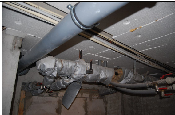
Foto nr. 20. Küttesüsteem on amortiseerunud.
